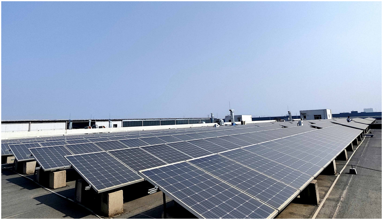
供应商工厂屋顶光伏电站
